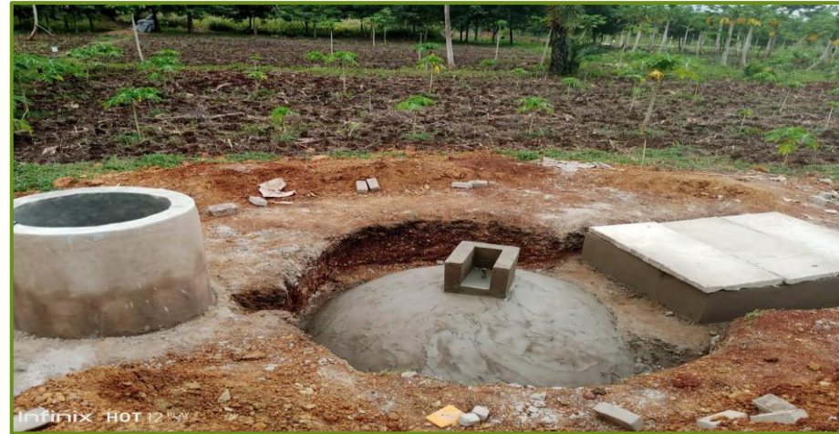
Biodigester construit dans un des centres
